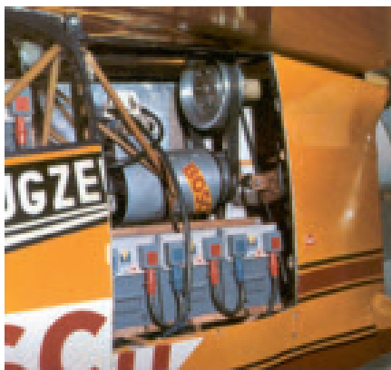
Bleibatterie in der Brditschka HB3 (1973)
